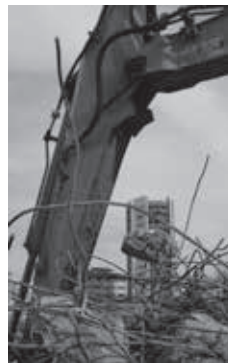
Primeres demolicions de lloses de paviment (gener de 2017). Fotografies de Josep M. Arjona i Borrego.
