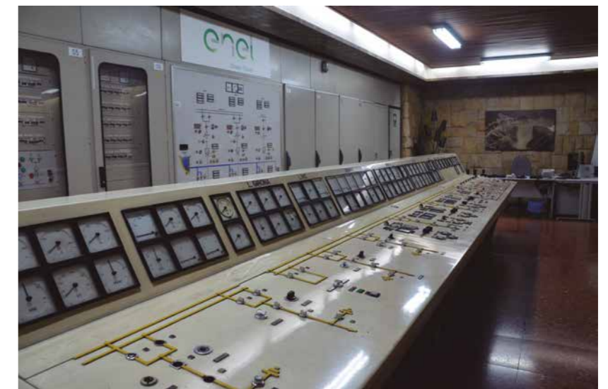
Primer panell de control de la presa. Foto Mia Masgrau
