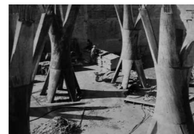
Pilars acabats de desencofrar. Fotografia del Sr. Calixto, operari a la construcció de Susqueda. Diari de Girona , 29 de novembre de 2009.
