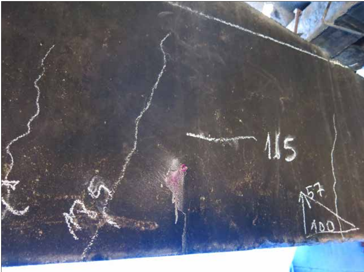
Encavallada de coberta d'una nau industrial afectada pel foc. Marcat de fissures, verificació de la profunditat de carbonatació i anàlisi mitjançant ultrasons. FONT: laboratori CECAM.
