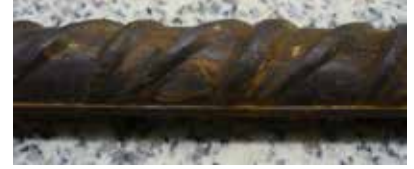
Barra d'acer B-500 SD afectada pel foc.
