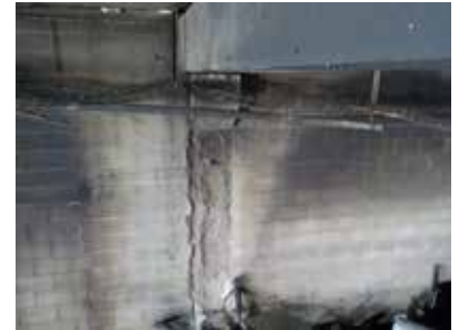
Pilar de formigó d'una nau industrial afectada pel foc.
