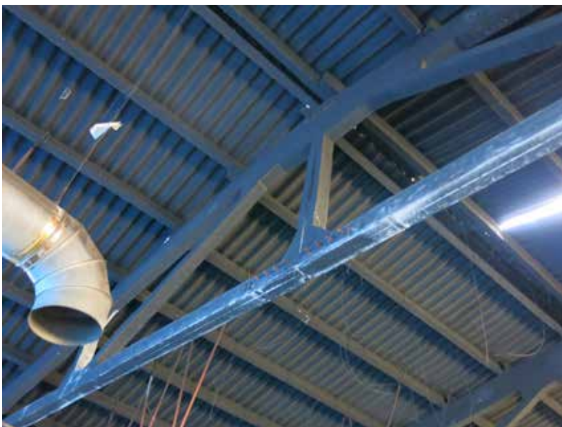
Encavallada de coberta d'una nau industrial afectada pel foc, on l'armat i la reduïda secció no permeten extreure testimonis sense afectar l'estructura. FONT: laboratori CECAM.
