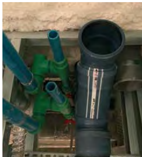
Connexions i instal·lacions preparades
