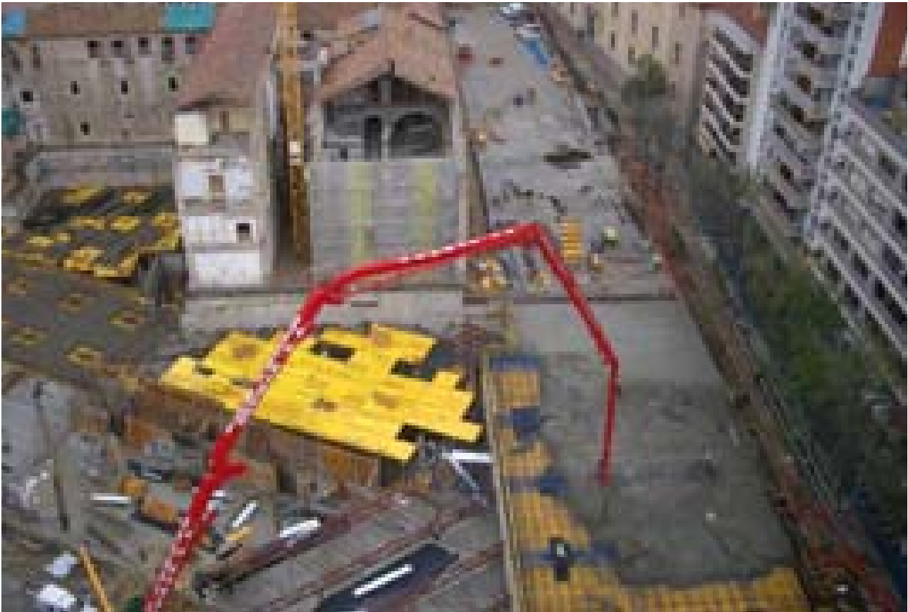
Fotografia 1. Vista de conjunt des del "bolet" de la plaça de Catalunya
