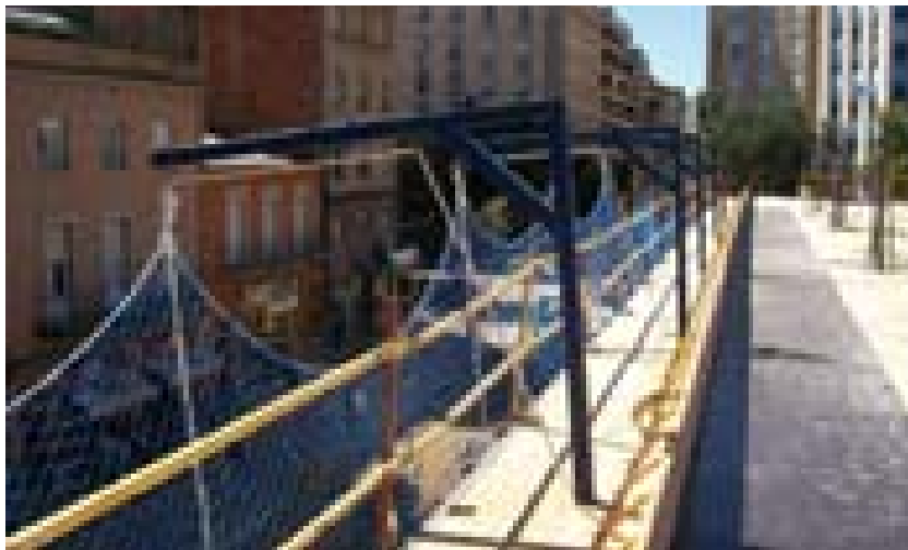
Vista del sistema de protecció del forjat amb els elements de seguretat.
