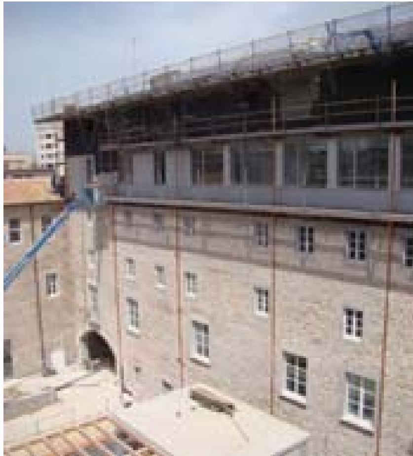
Treballs finals de la rehabilitació de les façanes interior del pati de la Casa de Convalescència.
