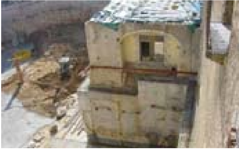
Fotografia 12 i figura 3. Imatge de l'edifici durant la fase d'excavació dels soterranis i esquema de l'atirantat.
