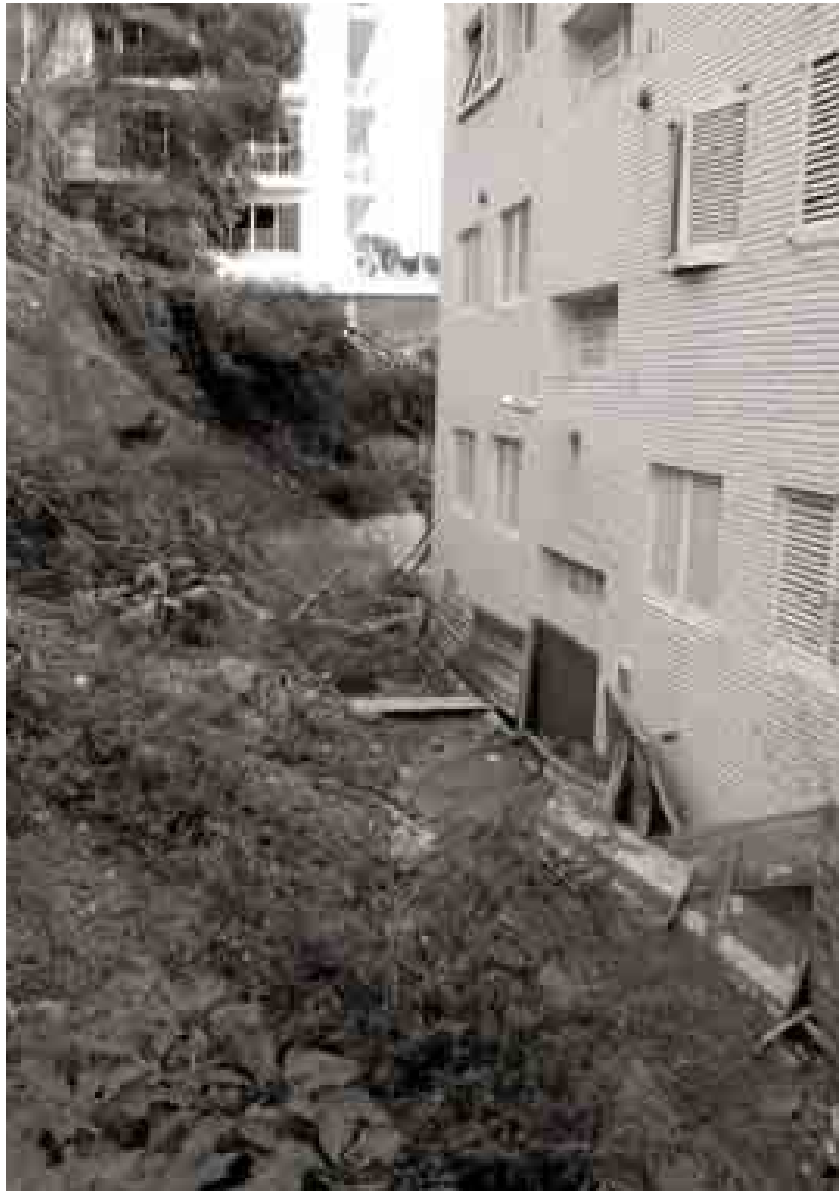
Edifici Nàutic, final carrer Illes, amenaçat per desprendiments de terra i roques.
