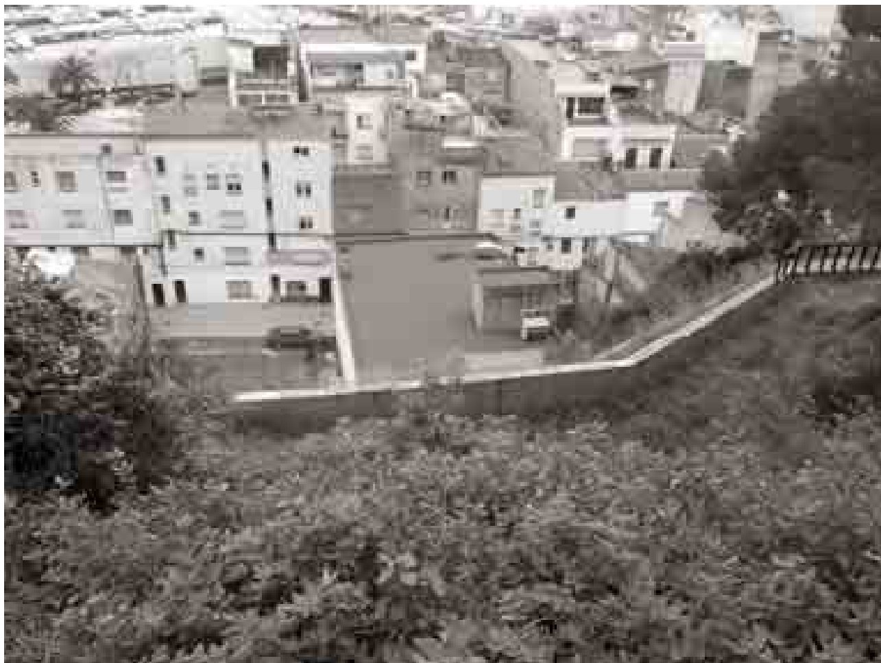
Mur de contenció des de dalt del vessant.
