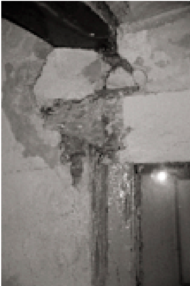
Figura 16. Llinda de fusta malmesa i afectada per fongs en el seu encastament al brancal de la finestra. Es pot observar que recolza en bona part al sobre del muntant. Al damunt hi ha una jàssera de fusta que es troba desplaçada originàriament del plom del brancal. Per acabar-ho d'adobar, tot aquest conjunt es va veure afectat pel moviment sísmic.
