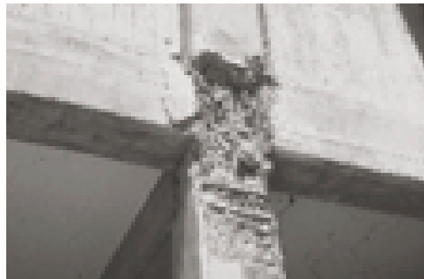
Foto 1. Esgotament d'un nus de connexió biga-pilar.
