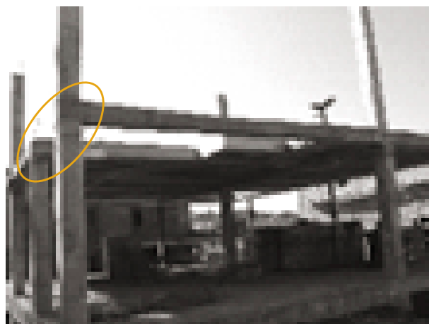
Foto 9. Falta de trava del pilar al nivell de forjat.
