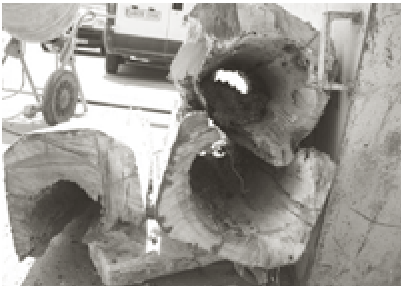
Detall del deteriorament de la secció, produït per una plaga de tèrmits subterranis, detectat pel mètode W-TEST, en un immoble de Salt (Gironès). Les incidències eren inapreciables des de l'exterior, inclús després d'aplicar-hi proves de duresa.
