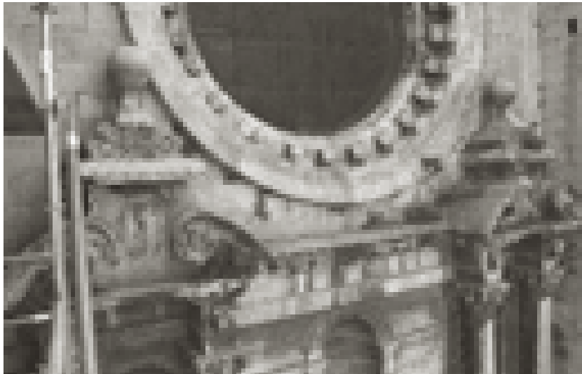
Base de la rosassa, abans de la restauració. (Foto: Jordi Paulí).
