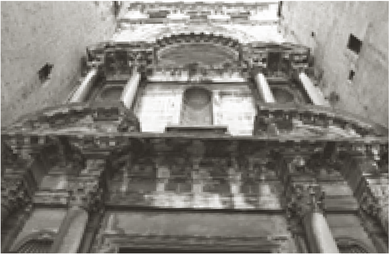
Estat de la façana abans de l'inici de les obres. (Foto: Jordi Paulí).
