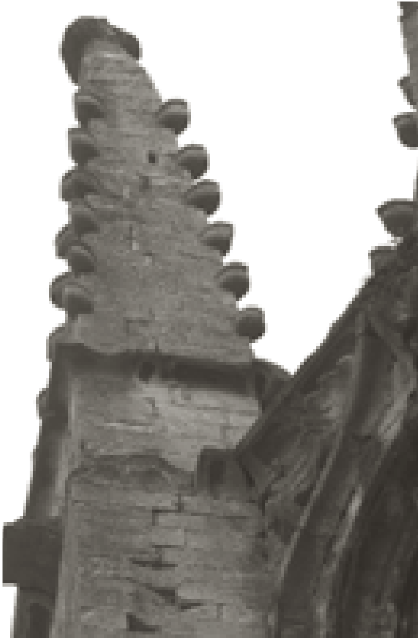
Aspecte inicial d'un dels pinacles, amb un important desplom, així com pèrdues de les cornises inferiors. (Foto: Jordi Paulí).
