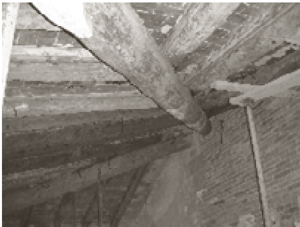
Cuina a la primera planta. Coberta en molt mal estat.
