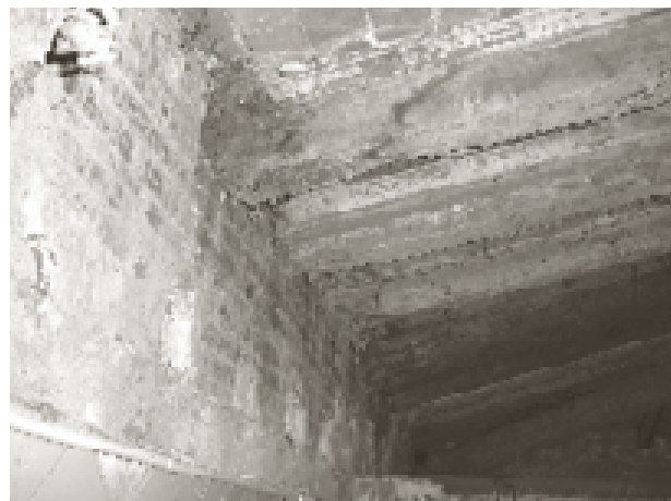
Cuina a la primera planta. Observeu els encastaments totalment desfalcats per l'efecte del tèrmit subterrani.
