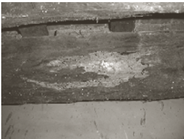
Biga de pollancre molt afectada per l'atac del tèrmit subterrani.
