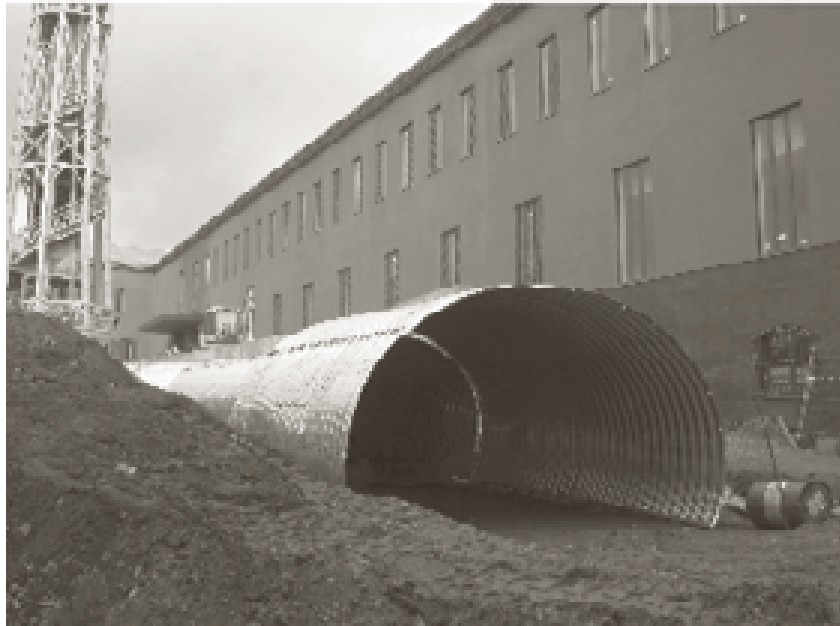
Detall de la construcció del túnel per accedir a la torre dipòsit. Fotografia de Josep Lois. Arxíu d'imatges del Museu del Suro.
