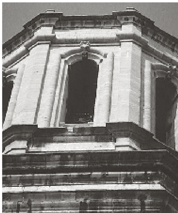
Escorrenties per les cornises. (Foto: CPA, SL).
