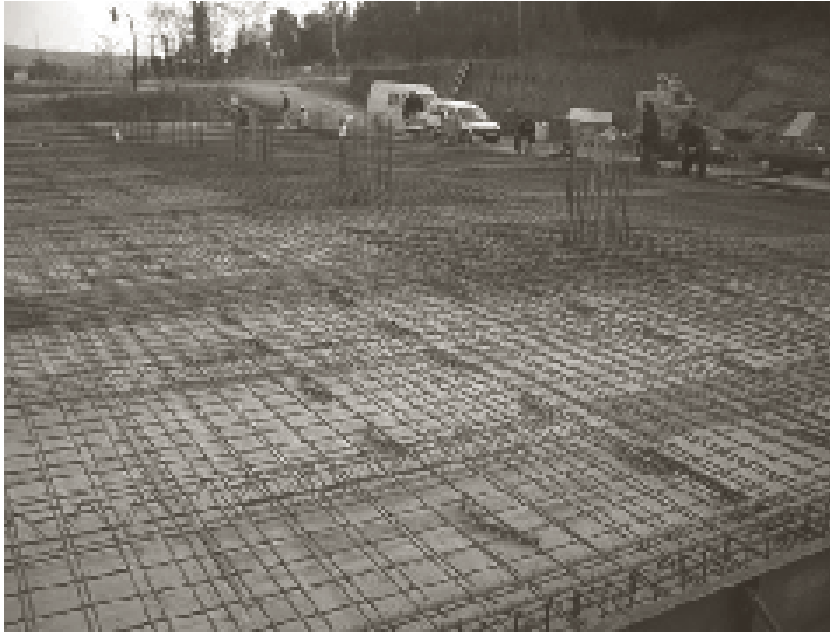
Fotografia 2: A la imatge es pot apreciar la poca curvatura dels cordons a causa del reduït cantell de la llosa.
