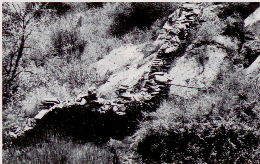
Mur de límit de propietat.
