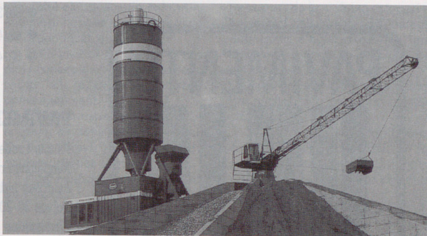
Central de formigó.
