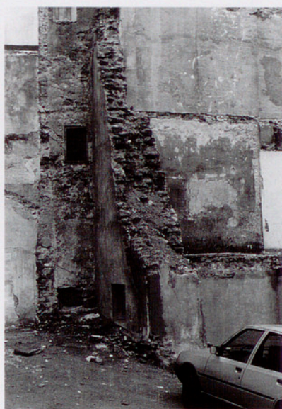
Les obres d'enderrocament d'un immoble varen descobrir un fragment de la muralla medieval.
