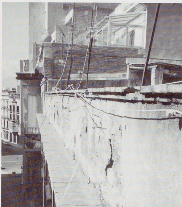
Els elements de coberta són els més exposats a la degradació. (Foto: F. X. B.)
