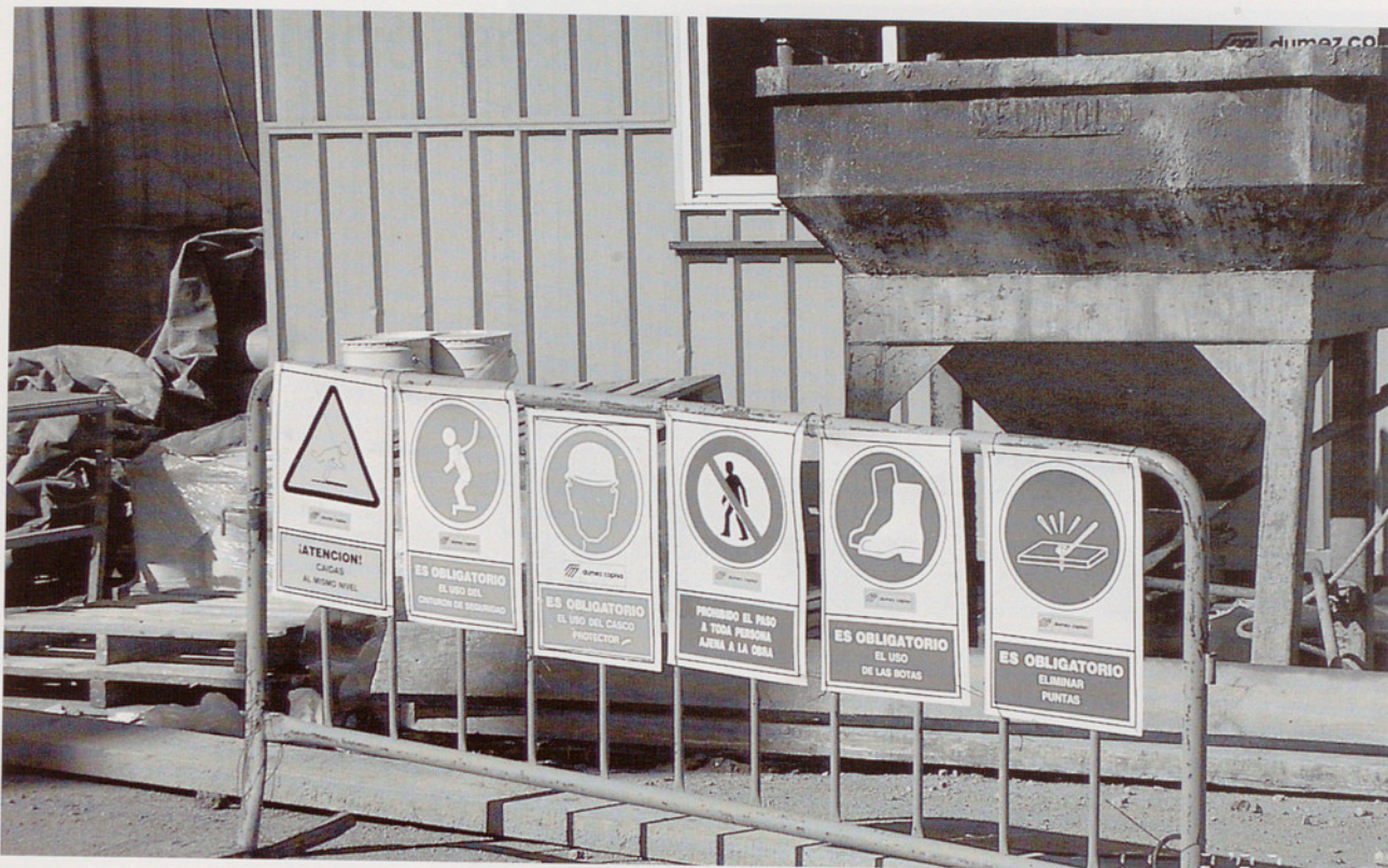
En els accessos a les obres cal assenyalar adequadament els riscos.
