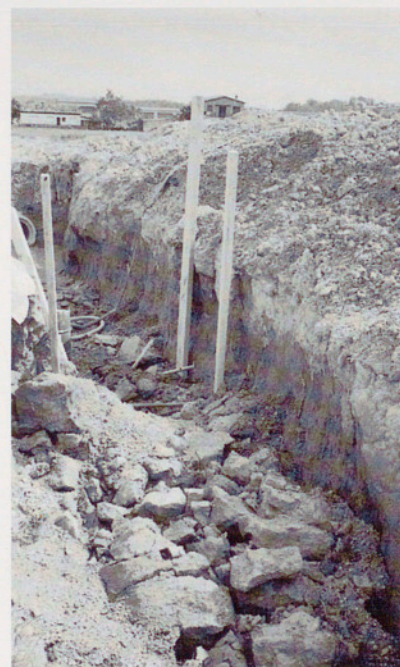
El despreniment de les terres d'una fossa provoca accidents irremeiables. (Foto: S. A.)
