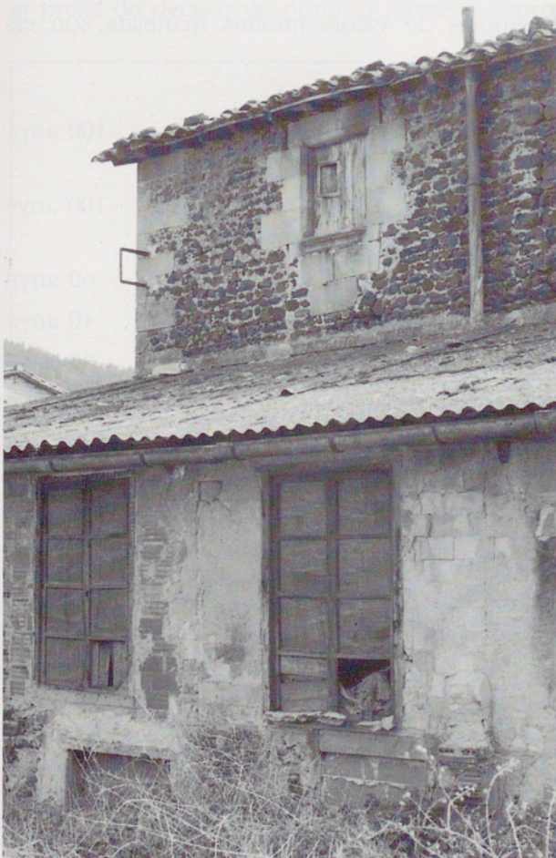
A les zones rurals la falta de manteniment provoca aquest aspecte. (Foto: F. X. B.)
