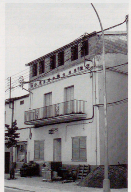
Les línies elèctriques són elements a protegir durant una obra. (Foto: F. X. B.)
